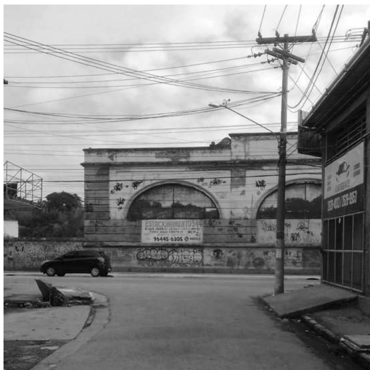
Fig. 27 – Fachada da antiga fábrica Hime em estado de ruína, 2019
