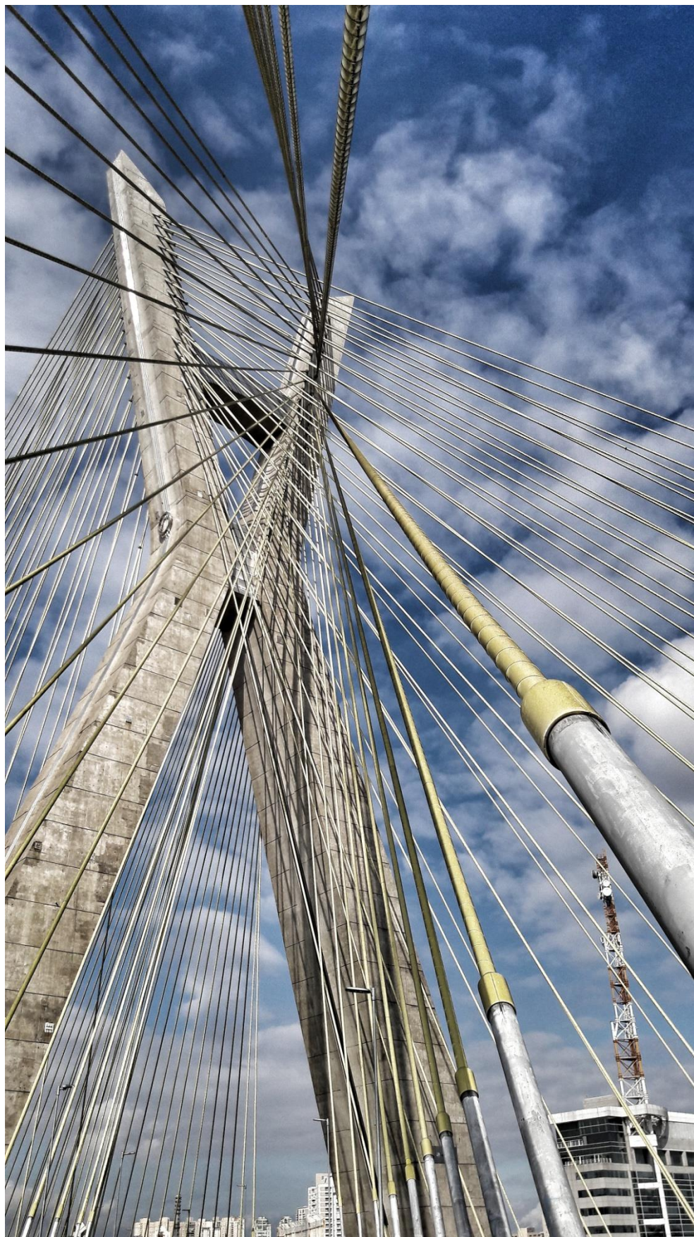
Imagem 40: Ponte Estaiada Octavio Frias de Oliveira V. Fonte: foto do próprio autor.
