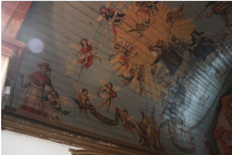
Teto da nave principal, Igreja de Nsa. Sra. do Carmo (2015) – Itu. Fonte: Fotografia original Lucas Garcia Nunes
